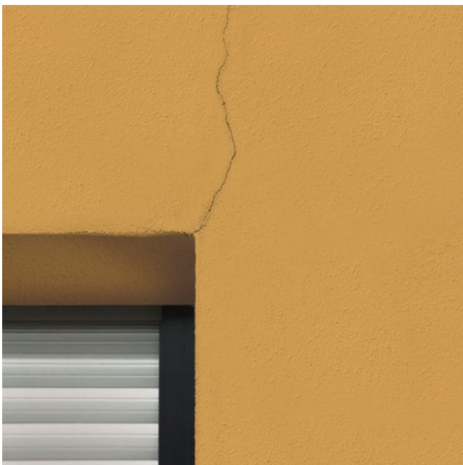
Cavillatura nello spigolo dell'apertura
