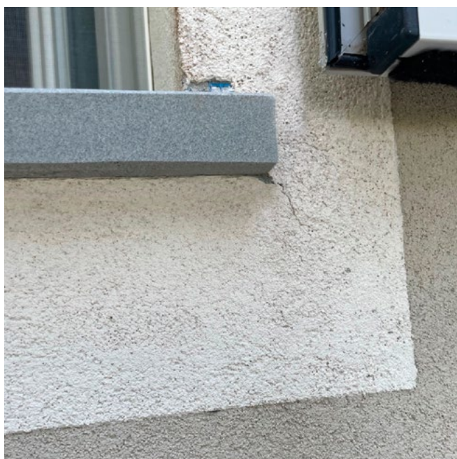
Cavillatura in prossimità del davanzale
