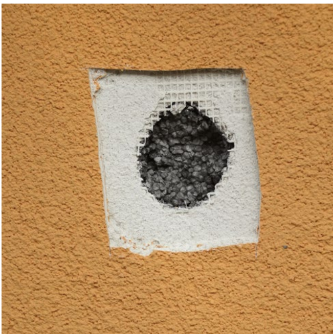
Danno accidentale esteso al pannello isolante
