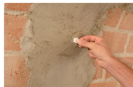
Inghisaggio degli ancoraggi e dei connettori con Geocalce FL Antisismico e chiusura del foro di iniezione con apposito tappo di chiusura.
