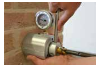
USO DO EXTRACTOR CERTIFICADO DA KERAKOLL PARA OS ENSAIOS PULL-OUT NA OBRA, PARA A VERIFICAÇÃO DA ADERÊNCIA DOS VARÕES APLICADOS
