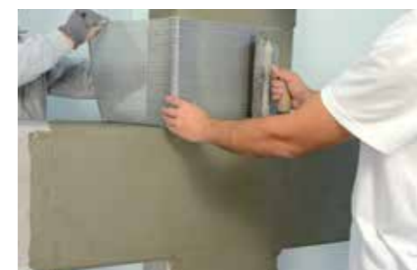
Aplicação da banda de tecido em fibra de aço GEOSTEEL para o envolvimento do pilar.
