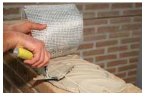
1 Extensión de la primera capa de GEOCALCE F ANTISISMICO y colocación del tejido GEOSTEEL.
